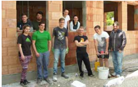
Eine Großbaustelle ist derzeit das Wagrainer Milchhaus. Der desolante Teil des Gebäudes wurde bereits abgerissen und ein neuer Zubau, in dem der Wagrainer Jugendtreff untergebracht wird, errichtet. Im Bild (v. l.) Michael Caslavka, Elisabeth Wellert, Laurenz Pöll, Florian Papst, Thomas Pflügler, Jakob und Liese Weber, Jürgen Tischer, Patrick Huber sowie Dorferneuerungsvereinsobmann und „Bauleiter“ Heinz Weber bei einem „Jugendtreff-Arbeitseinsatz“.
