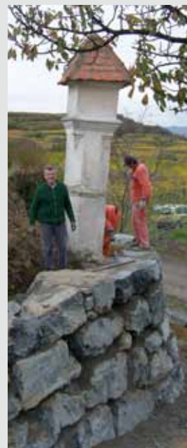
Mit der Renovierung des „Judweg - Bildstocks“, der sich auf einer steilen Böschung (inmitten von Weingärten an einer Feldwegkreuzung in Richtung Hollenburg) befindet, wurde begonnen. Als erster und wichtigster Schritt wurde eine Steinmauer zur Abstützung des Marterls errichtet.
